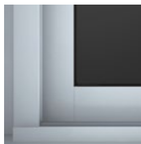
Detalle ext: parte inferior drenaje oculto
